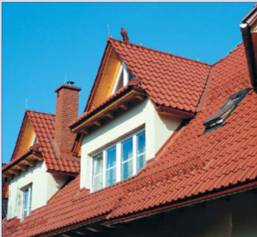
3 Obłożenie klinkierem wystającej ponad dach części komina zwiększa jego trwałość (fot. CRH Klinker)
